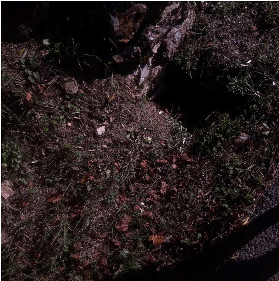
Foto 2 Attraversamento stradale comunale esistente otturata.
