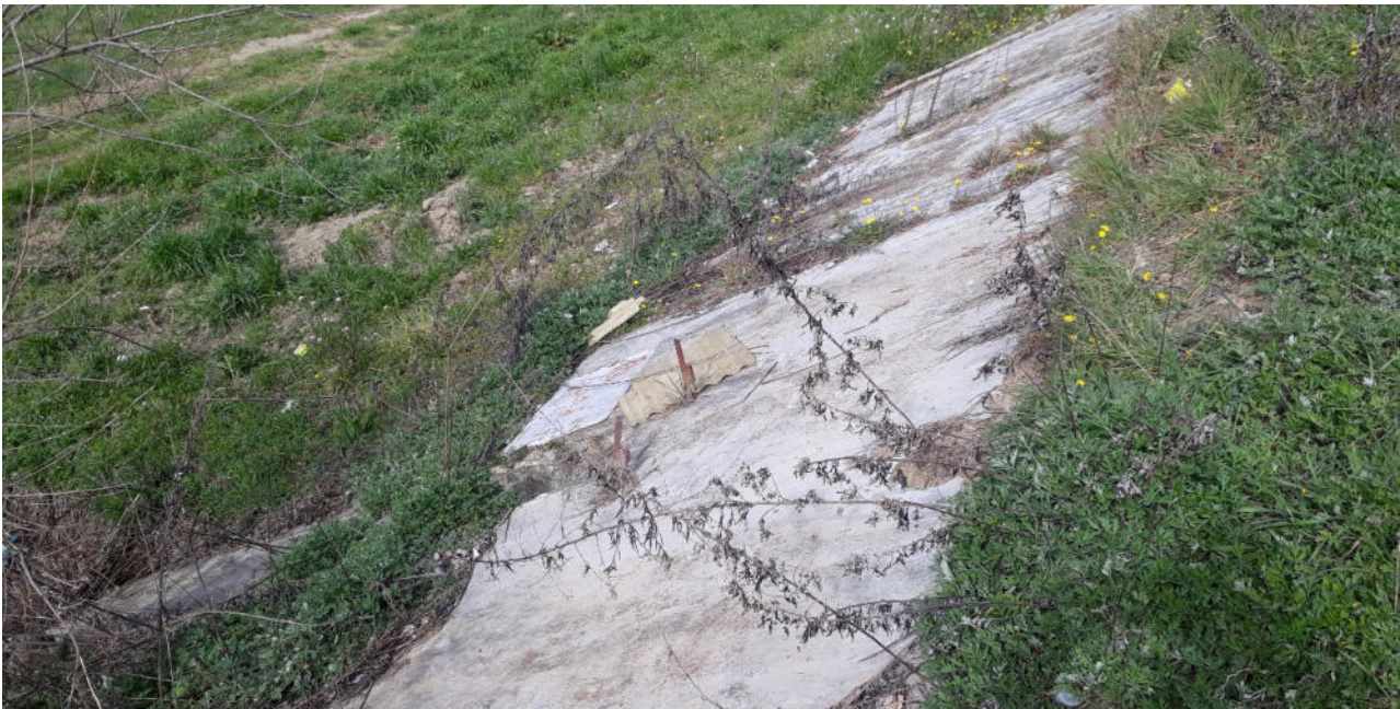
Foto n. 11 – Vista in cui il tombino esistente (da adeguare) scarica nell’Arno. Visibile il rivestimento in calcestruzzo del ciglio di scarpata. L’area è interna al vincolo paesaggistico.
